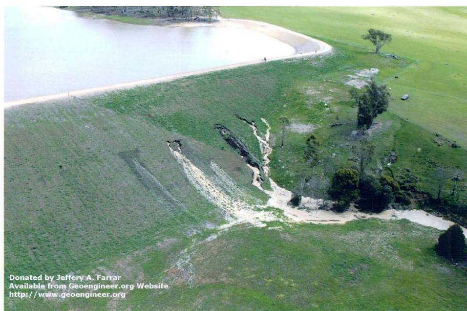
Slika 29: Primer napredovane notranje erozije v nasuti pregradi (vir: geoengineer.org ).
