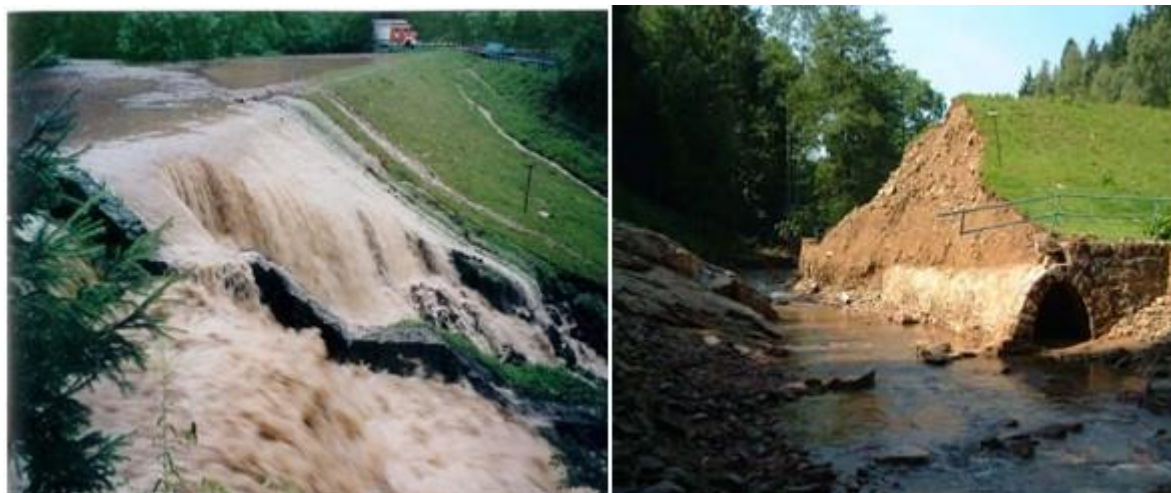
Slika 28: Porušitev ob pojavu poplavnih voda zaradi nezadostne kapacitete prelivnega polja (vir: https://damfailures.org/lessons-learned ).
