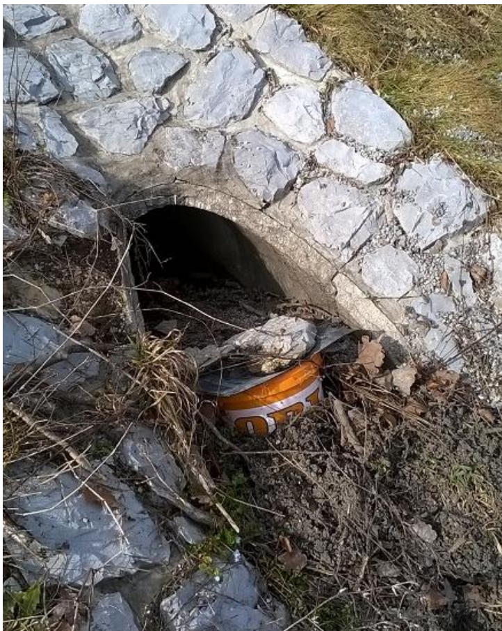
Slika 6: Vedro, zaprto s pokrovom, na koncu podhoda za dvoživke na odseku Bevke.
